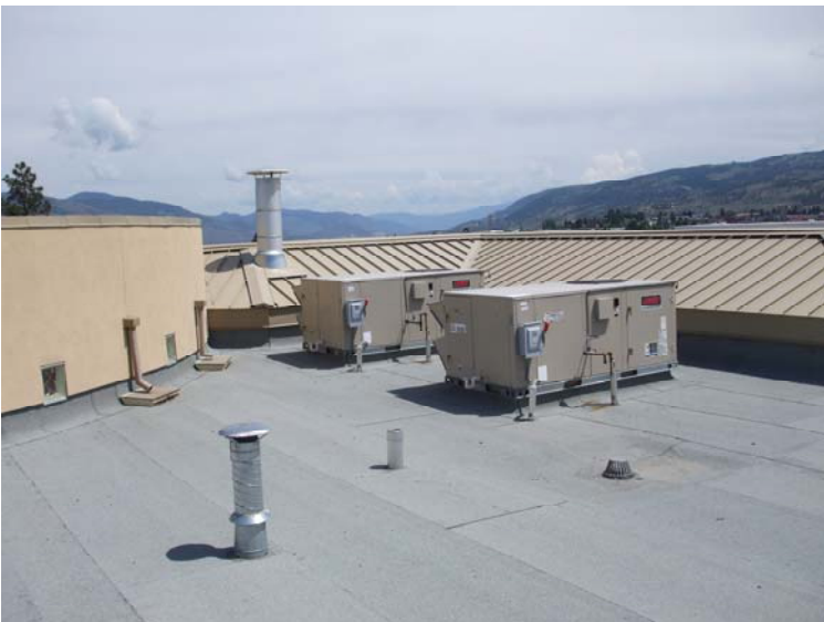
3. RTU-5 and RTU-6.JPG
