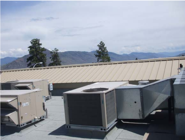
1. RTU-1 and RTU-2.JPG
