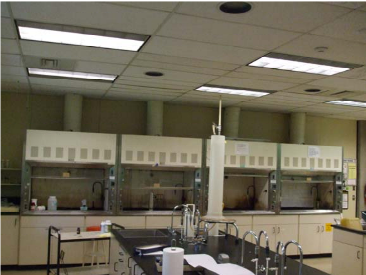
9. Fume Hood Fans 2.JPG
