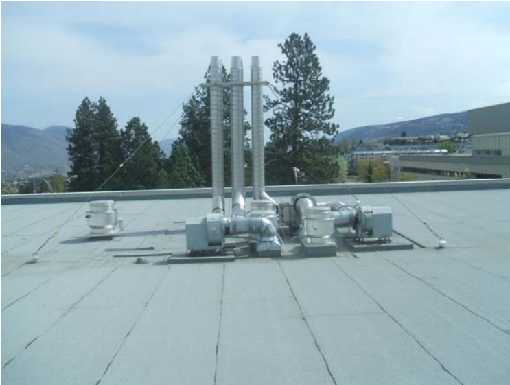
14. C-block Exhaust Fans.JPG
