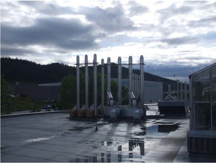
8. Fume Hood Fans.JPG
