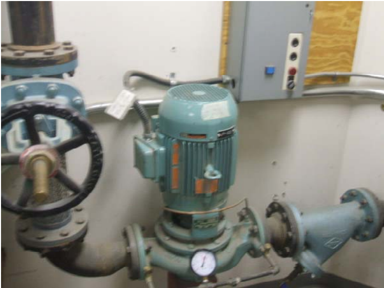
4. Loop Pump P-101.JPG
